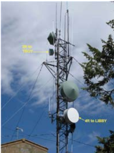
Torre del Repetidor en King Mountain
